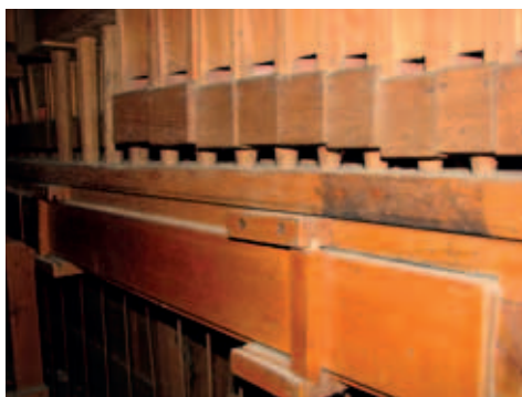
Fot. 11. Wiatrownica pedału, widoczne otwory żerowania drewnojadów (fot. autor)
