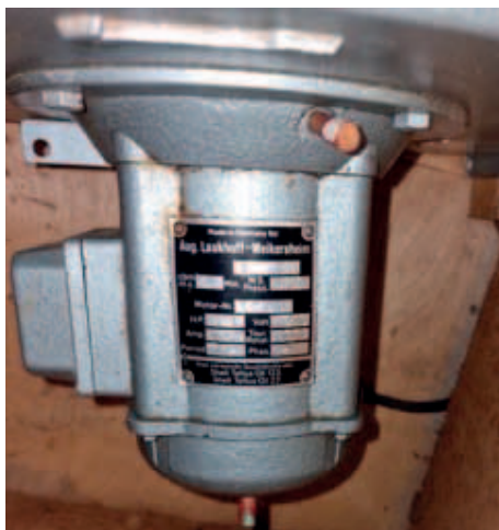
Fot. 2. Silnik dmuchawy elektrycznej
