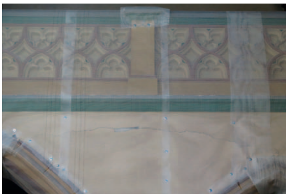
Fot. 5. Pęknięcia wewnątrz świątyni
